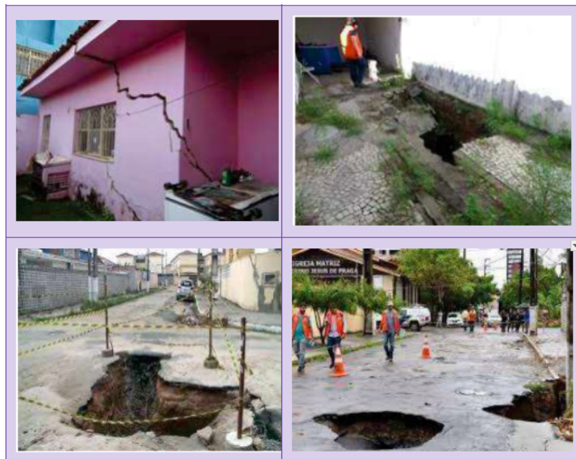
Figura 5: registros de rachaduras e buracos após chuvas e tremores em março de 2018 (Alagoas/MPAL, 2019).
